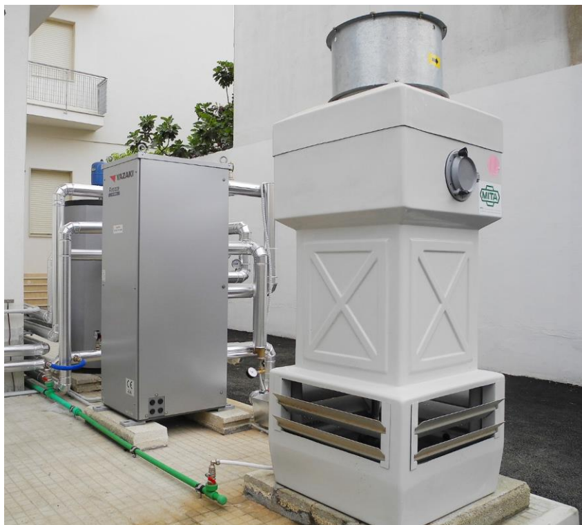
Rysunek 4. Przykład instalacji zewnętrznej agregatu absorpcyjnego Yazaki z wieżą MITA.
