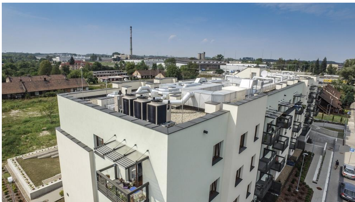
Absorpcyjne pompy ciepła Robur zamontowane na dachu budynku wielorodzinnego w Tarnowie
