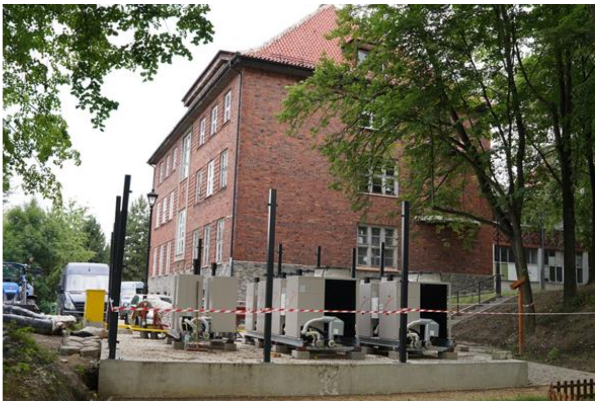
Zespół Szkół Rolniczych w Prudniku, na zewnątrz zainstalowano absorpcyjne pompy ciepła zasilane gazem i kotły kondensacyjne Robur. Źródło: powiatprudnicki.pl
