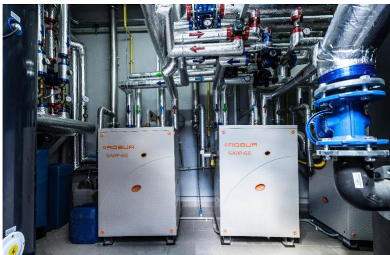
Rysunek 4. Zestaw absorpcyjnych pomp ciepła zasilanych gazem typu grunt/woda GAHP-GS zainstalowanych w obiekcie handlowym.
