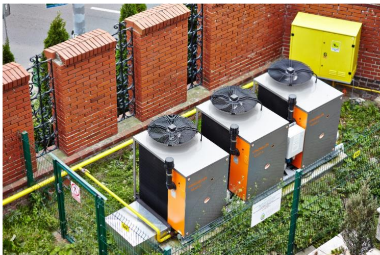
Rysunek 3. Zestaw absorpcyjnych pomp ciepła Robur GAHP-A zainstalowanych przed budynkiem.
