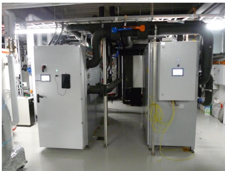
Rysunek 4. Zastosowanie pompy ciepła Oilon w przemyśle - Kokkola, Finlandia
