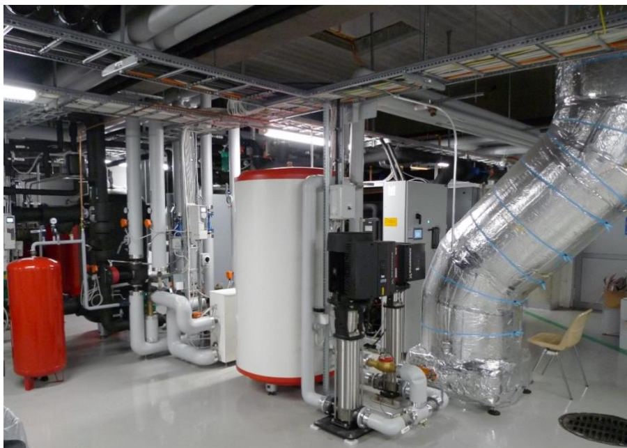
Rysunek 2. Zastosowanie pompy ciepła Oilon w przemyśle - Kokkola, Finlandia
