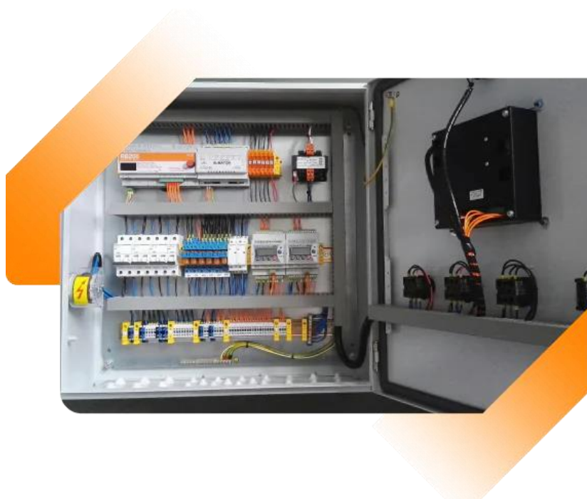
Rys.1 Szafa automatyki podstawowej.
