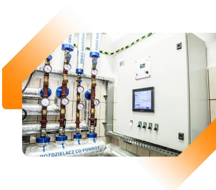
Rys. 2 Szafa automatyki dedykowanej.
