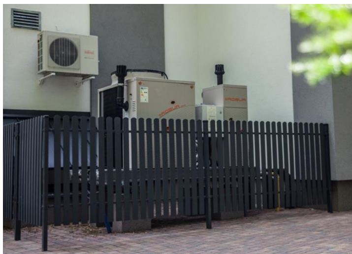
Estetyczne ogrodzenie przysłaniające urządzenia.
