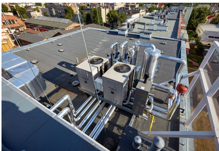
Urządzenia zlokalizowane na dachu budynku.
