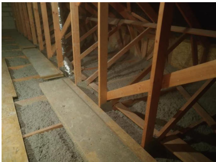
Ilustracja 3. Po wełnie celulozowej nie można chodzić. Na poddaszach, do których ma być zachowany dostęp, należy wykonać podłogę techniczną.
