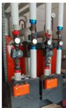
Zdjęcie 3. Izolacja na rozprowadzeniu instalacji grzewczej
