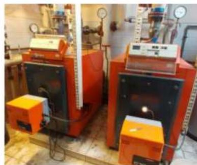
Zdjęcie 1. Kotły gazowe
