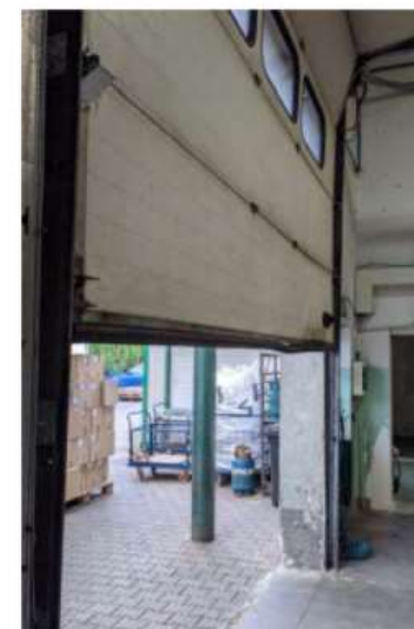
Zdjęcie 4. Brama przemysłowa koło sprężarki
