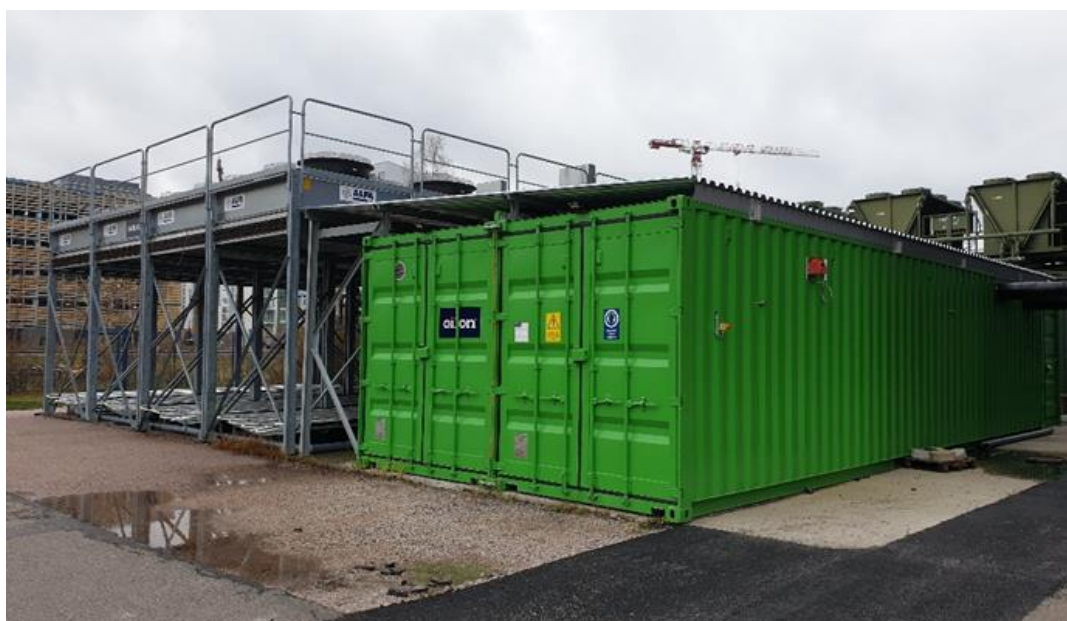
Zdjęcie 3. Pompa ciepła Oilon zainstalowana w kontenerze
