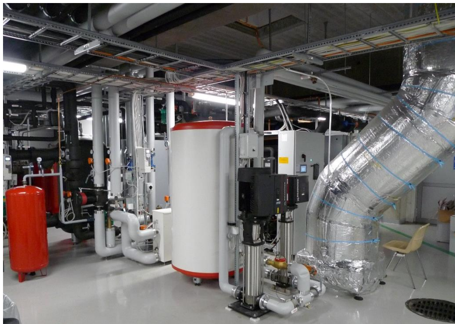
Rysunek 2. Zastosowane pompy ciepła Oilon w przemyśle - Kokkola, Finlandia
