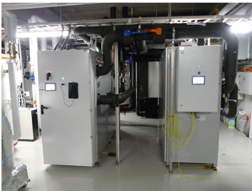
Rysunek 3. Zastosowane pompy ciepła Oilon w przemyśle - Kokkola, Finlandia
