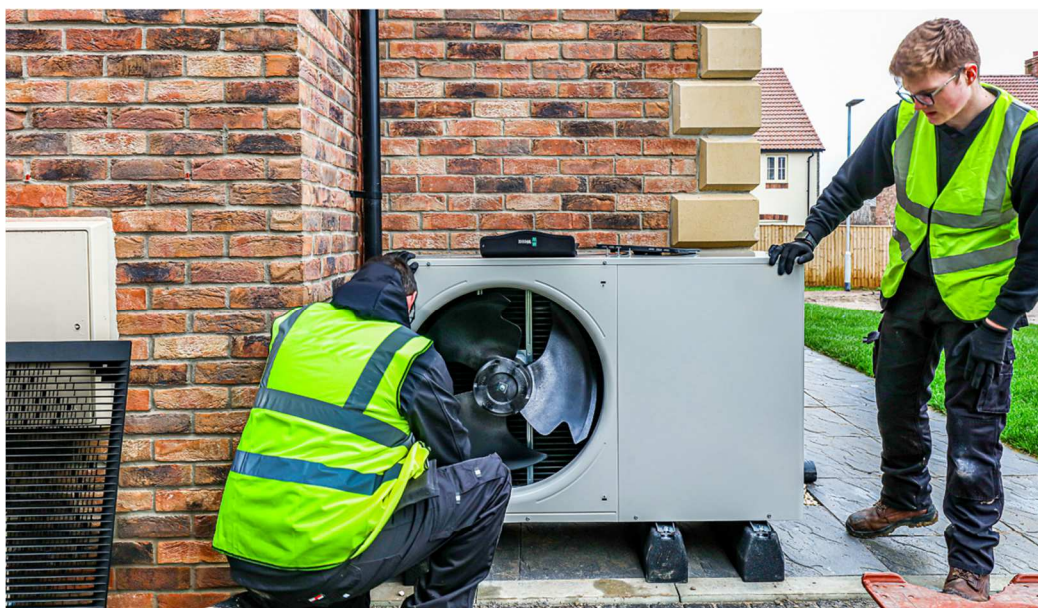
Rys. 3 Do rozwoju instalacji pomp ciepła na rynku potrzeba więcej i bardziej wykwalifikowanych instalatorów.
