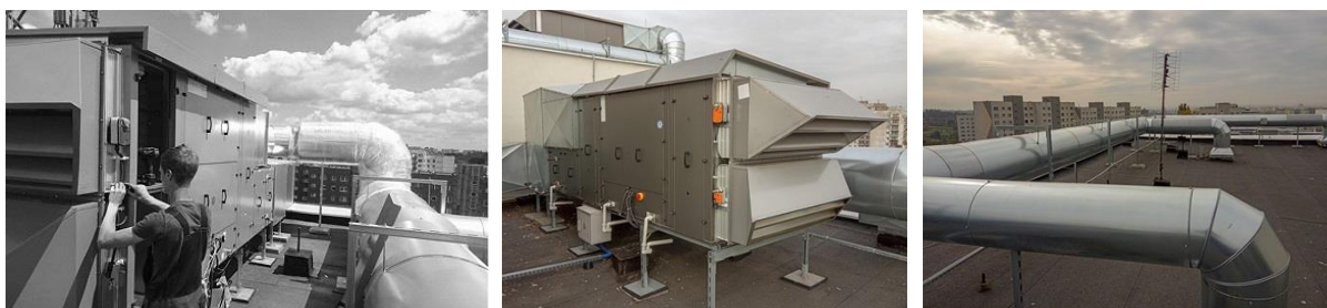
Fot. Centrala nawiewno-wywiewna z odzyskiem ciepła na dachach budynków spółdzielni w Sosnowcu Fot. Frapol
