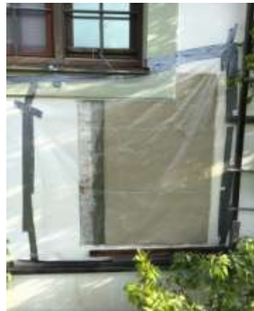
ochrona przed utratą wilgoci
