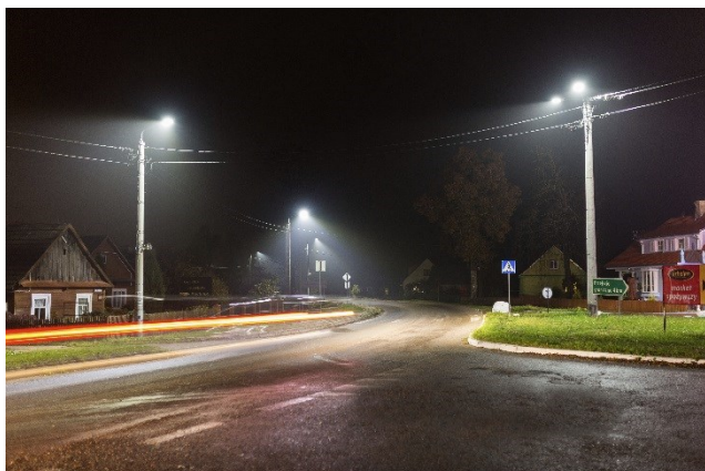
Oprawy oświetleniowe UniStreet z systemem sterownia City Touch firmy Philips
